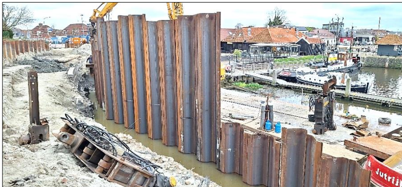
Beeld van het aanbrengen van damwanden voor de fiets- en voetgangersbrug Reitdiep
